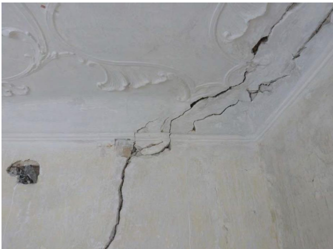
Decke mit Rissen
